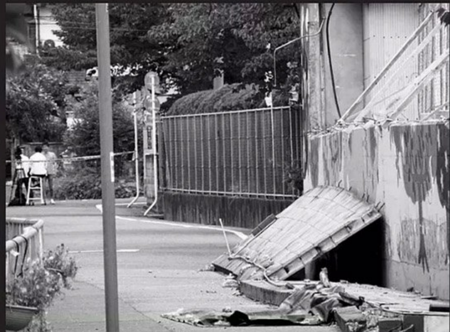
大阪の地震で崩壊したプールのブロック塀は、建築基準法に違反したものだ
